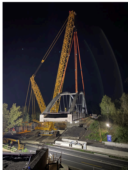
Osazení konstrukce o hmotnosti cca 400 t provedl večer 12. října samotný jeřáb Liebherr LR 1750
